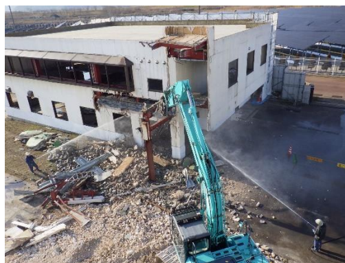
中之島クリーンセンターごみ処理施設(管理棟) の解体工事の様子
