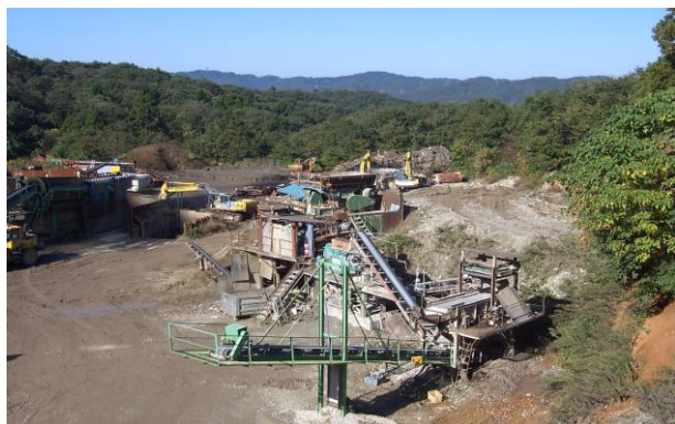
破砕処理プラント
